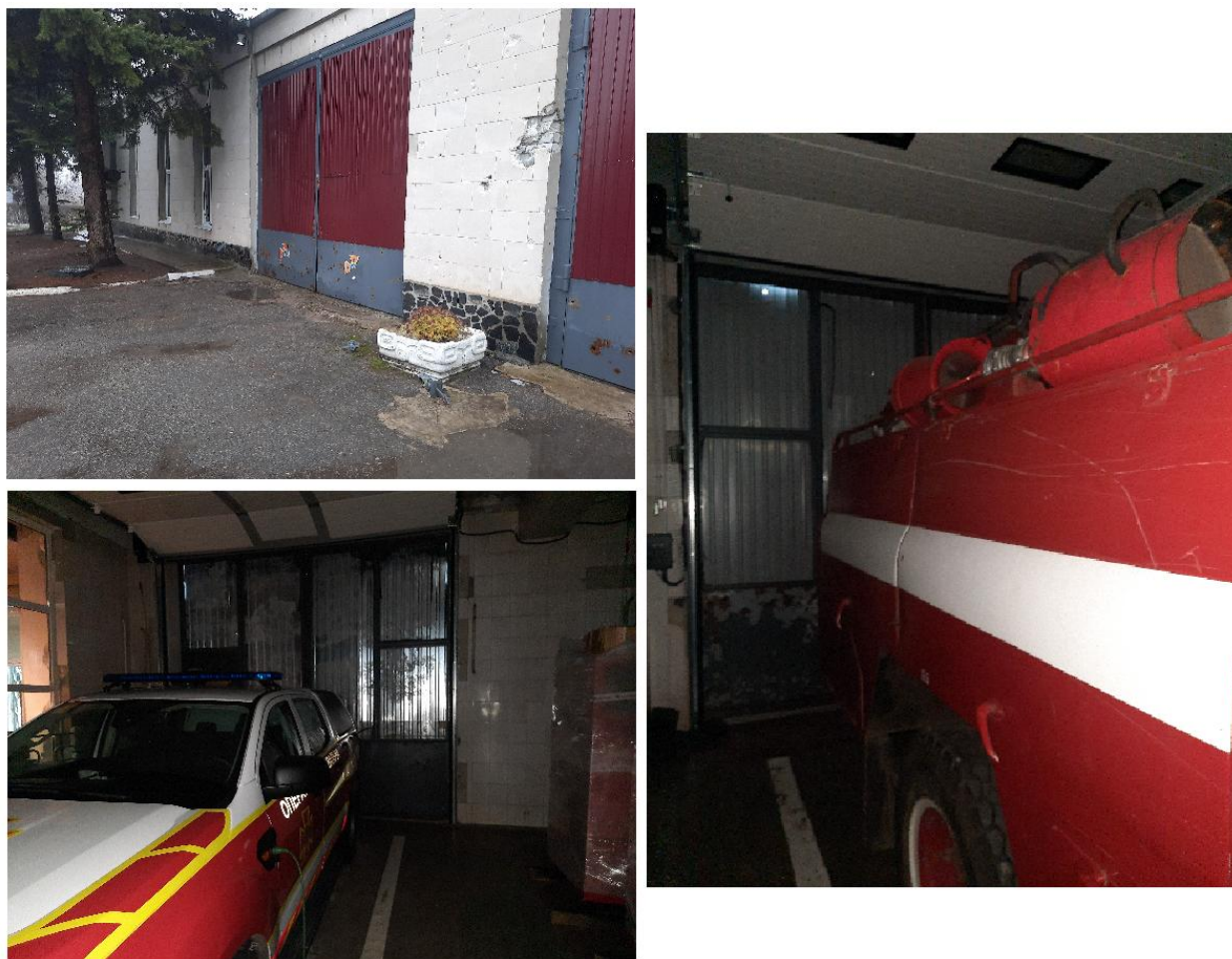
Рис. 3.2. Стан воріт після обстрілу прилеглої території (скло замінено профнастилом). Приклади розміщення оперативних транспортних засобів задньою частиною до виїзних воріт
